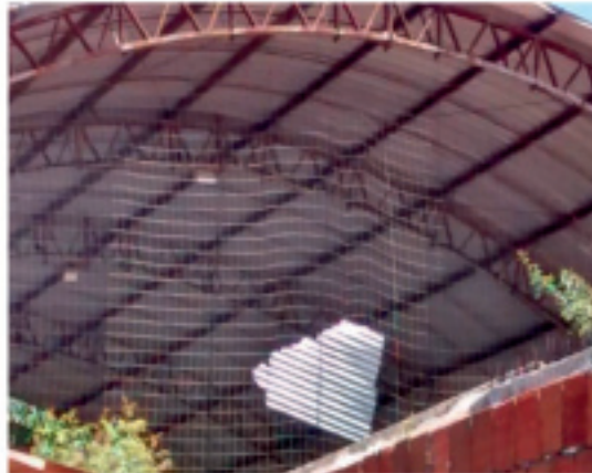
Figura 4 – Pedacos de telhas rasgadas – Quadra A Fonte: Autor (2017)
