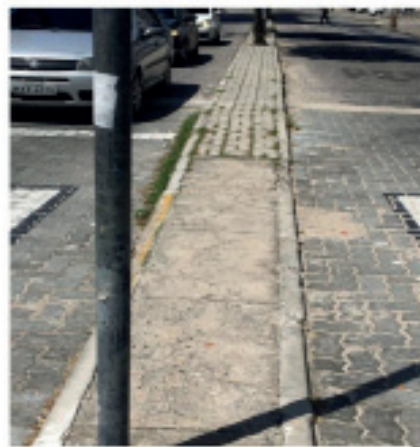
Inexistência do corte no canteiro central
