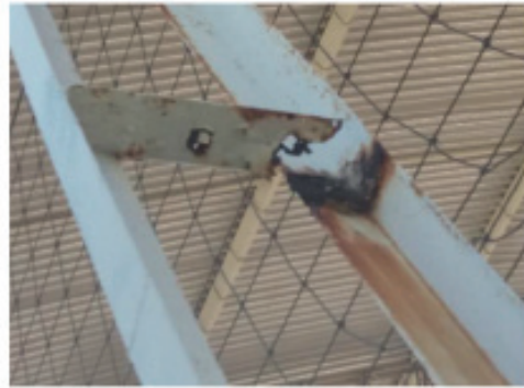
Figura 12 – Degradação da estrutura – Quadra D
