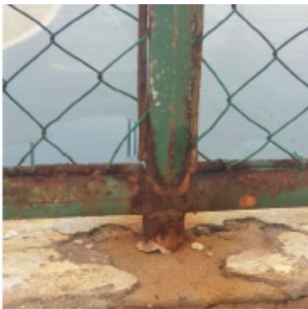
Figura 13 – Deterioração das juntas – Quadra E E Fonte: Autor (2017)
