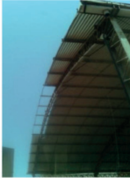
Figura 5 – Pedacos de telhas rasgadas – Quadra A Fonte: Autor (2017)
