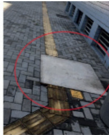
Interrupção do piso tátil
