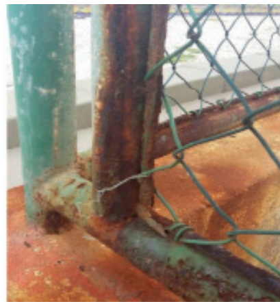
Figura 14 – Deterioração das juntas – Quadra
