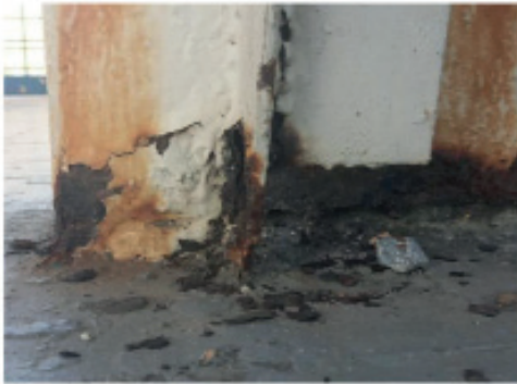
Figura 11 – Degradação da estrutura – Quadra D Fonte: Autor (2017)
