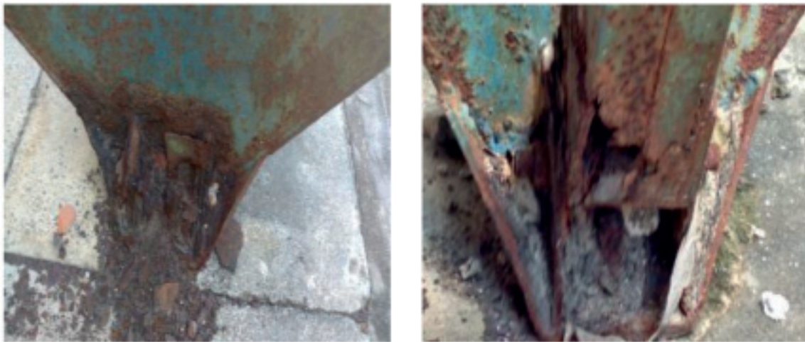
Figuras 6 e 7 - Ligação base-estrutura metálica degradadas – Quadra B Fonte: Autor (2017)
