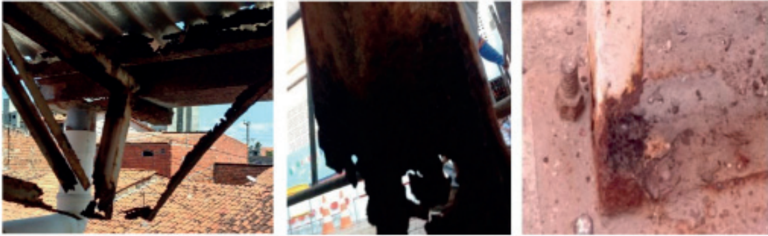
Figuras 8, 9 e 10 – Corrosão nas juntas de ligação – Quadra C. Fonte: Autor (2017)
