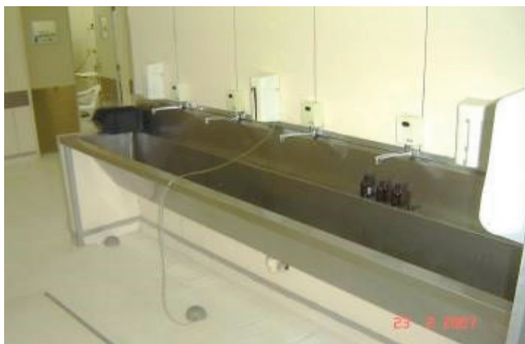
FIGURA 1– Lavabo do Centro cirúrgico (HUOL-UFRN).
