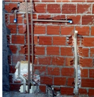
Figura 9 - situação real referente à execução da instalação.
